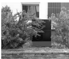
Die Kombination Wärmepumpe und PV ist energetisch besonders sinnvoll.
