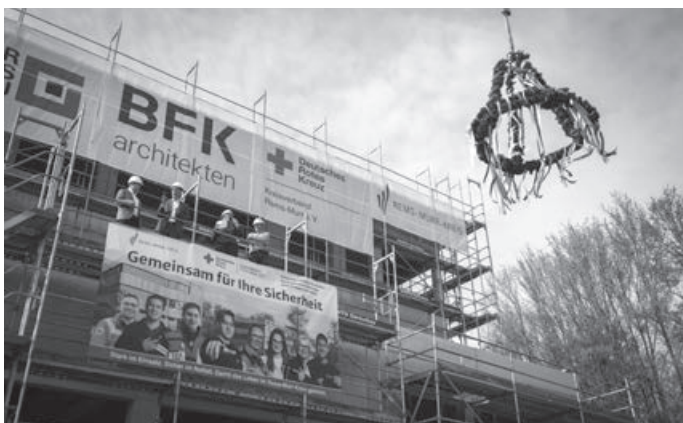
Richtspruch für das Jahrhundertprojekt in Waiblingen mit DRK-Kreisgeschäftsführer Sven Knödler, Landrat und DRK-Präsident Dr. Richard Sigel und Bauleiterin Carmela Palinkas von Peter Gross Bau, dem Totalunternehmer für das Neubauprojekt (von links)
